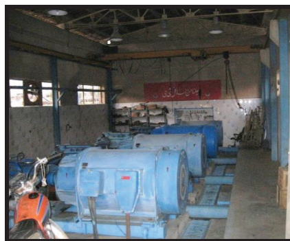
شکل ۱۲: نمایی از یک ایستگاه پمپاژ آب
